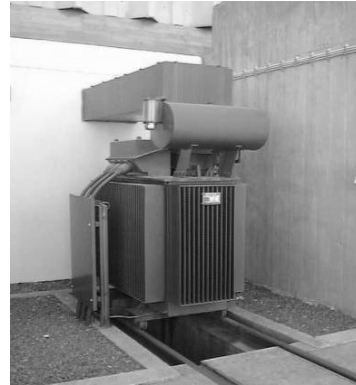
Transformador trifásico interior
