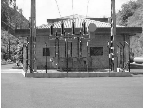
Transformador de potencia
