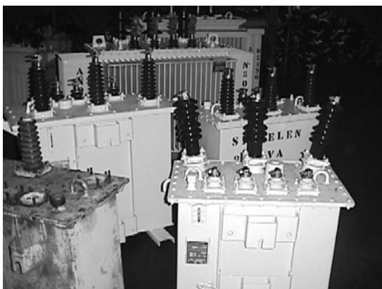
Transformadores de distribución empresa Eléctrica
