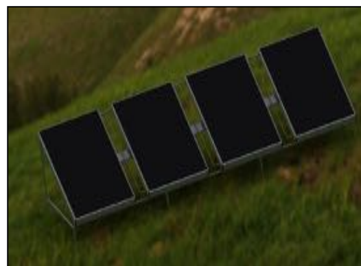
Fig. 4 Vista lateral de los colectores montados en la estructura.
